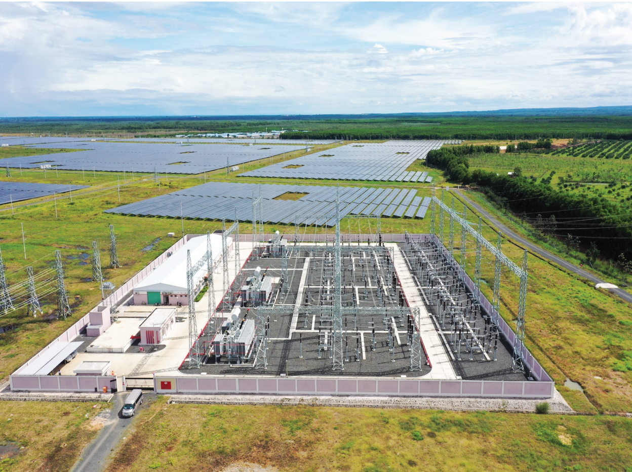
Nhà máy Điện năng lượng mặt trời huyện Lộc Ninh.
