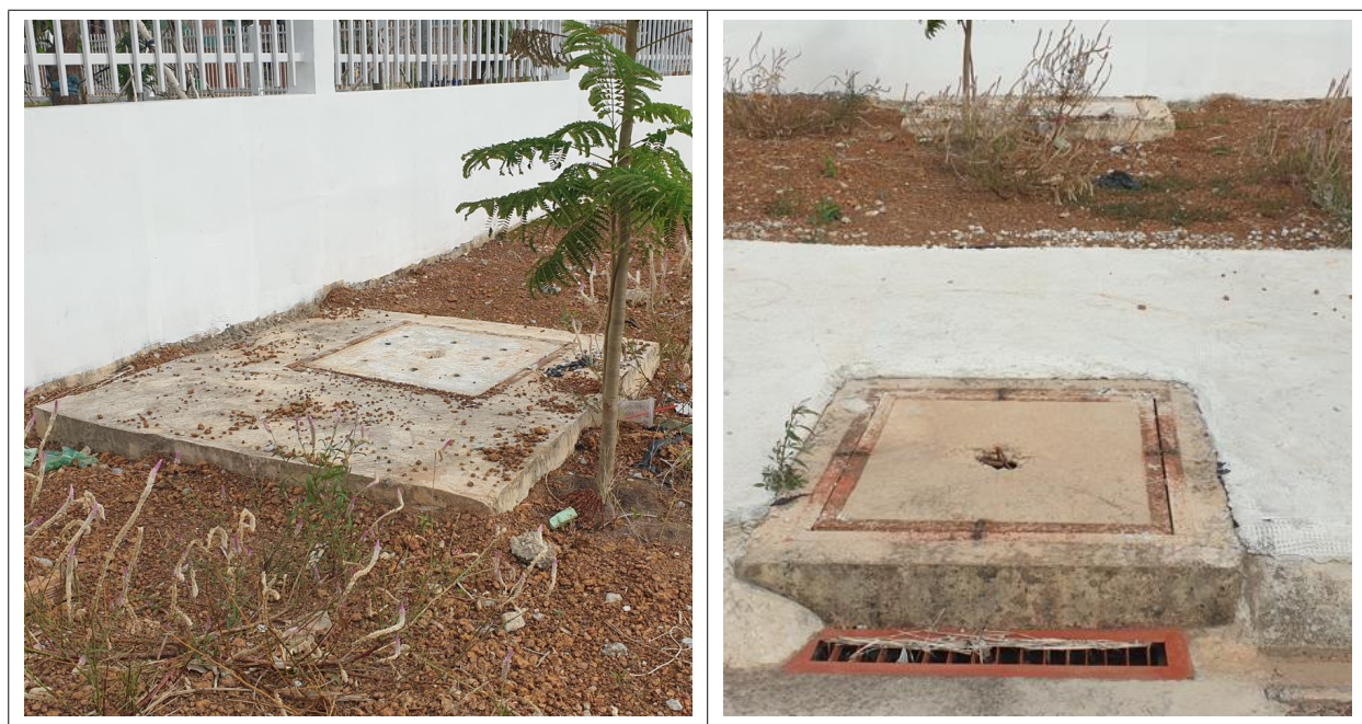
Hình 3.3 - Hồ ga thu gom nước mưa từ các nhà xưởng trước khi xả ra cống thoát nước mưa chung của Khu công nghiệp Đồng Xoài III
