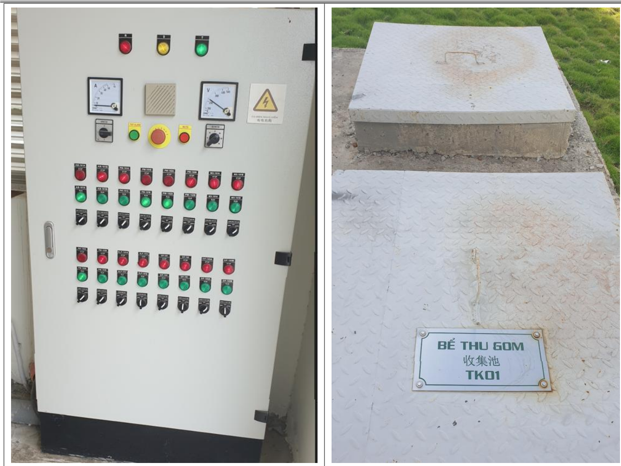
Hình 3.10 - Hệ thống xử lý nước thải của cơ sở
