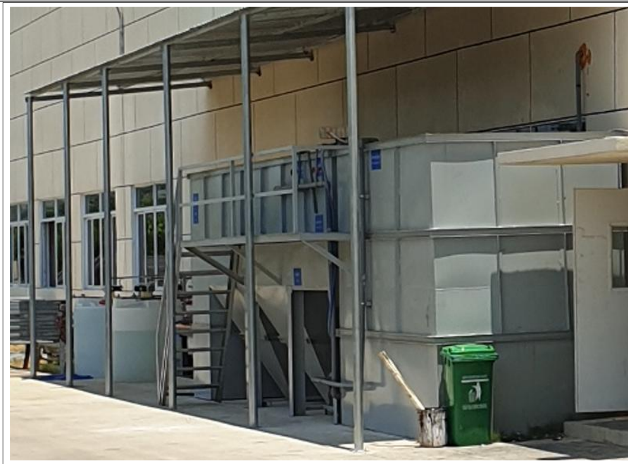
Hình 3.14 - Hệ thống xử lý nước thải sản xuất khu sơn của cơ sở
