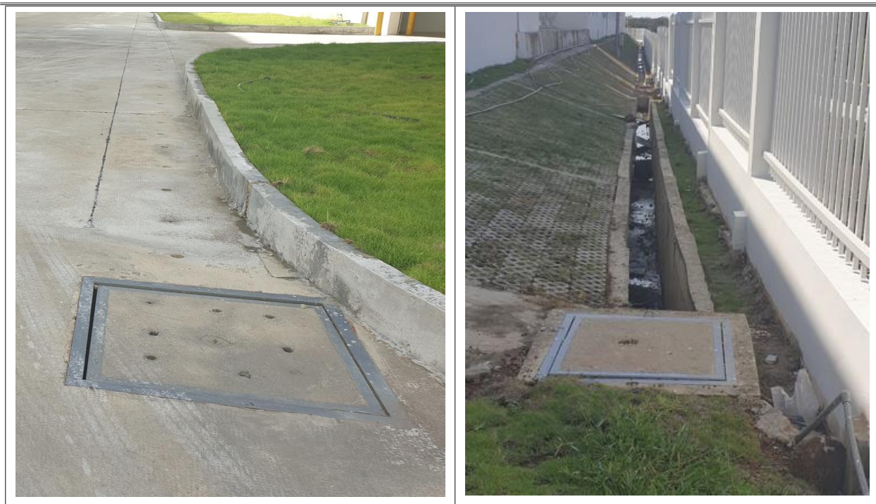
Hình 3.2 - Hồ ga thu gom nước mưa xung quanh các nhà xưởng
