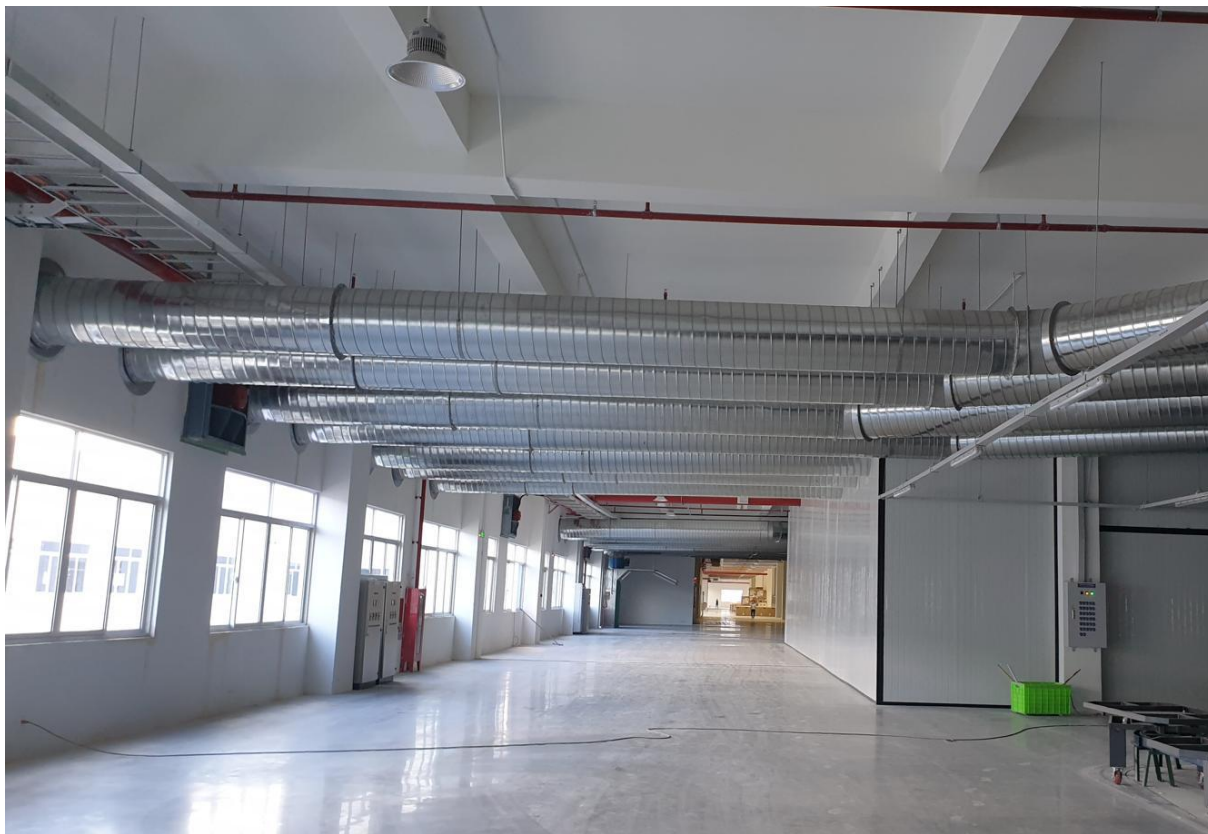
Hình 3.20 - Hình ảnh hệ thống thu gom bụi sơn và hơi dung môi
