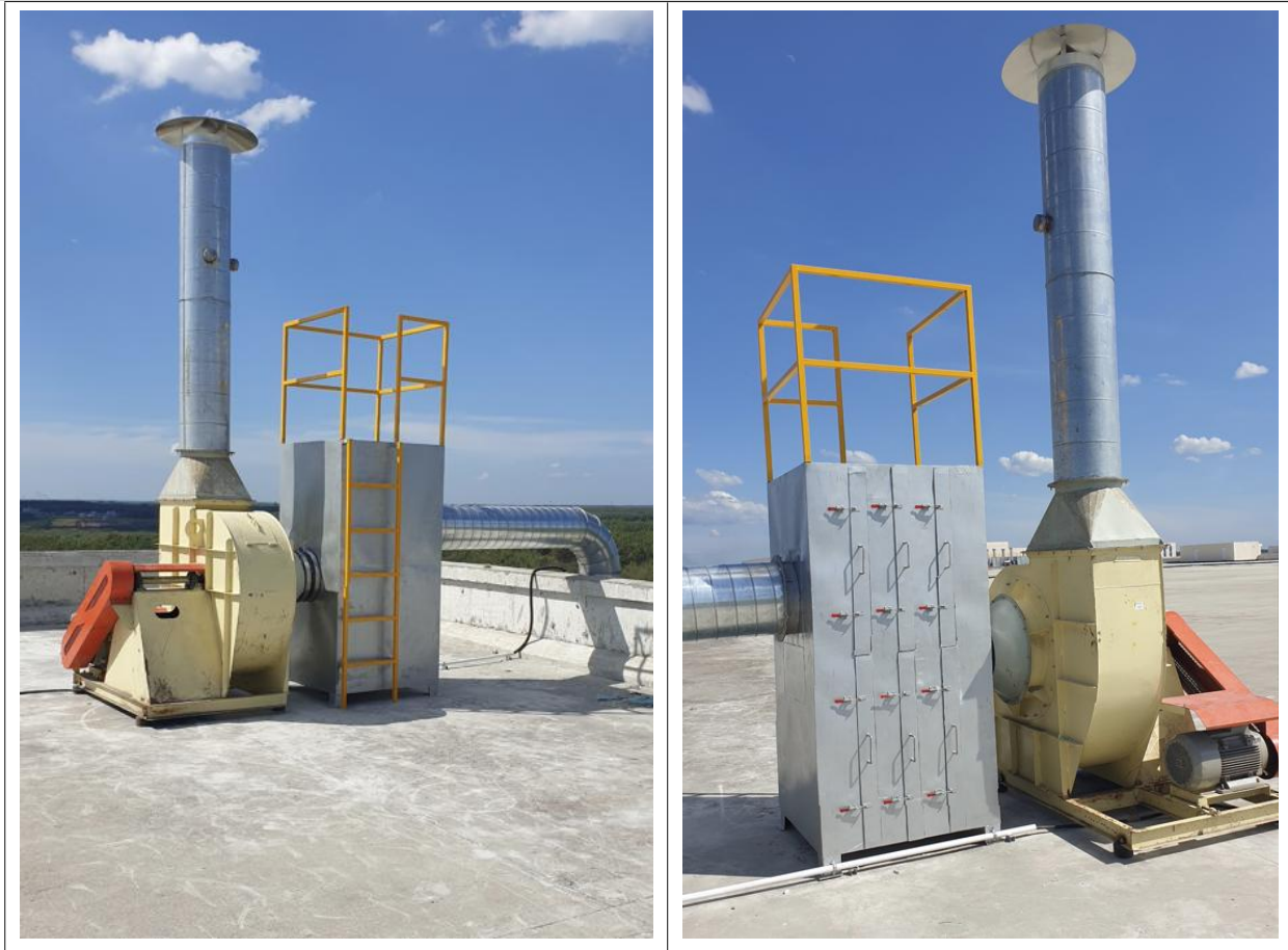
Hình 3.26 - Một số hình ảnh hệ thống xử lý hơi keo của nhà máy
