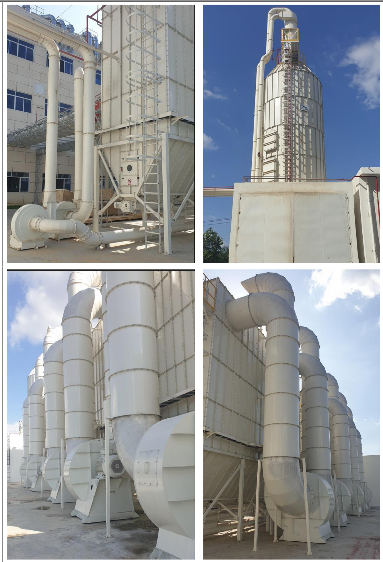
Hình 3.17 - Một số hình ảnh hệ thống xử lý bụi của nhà máy
