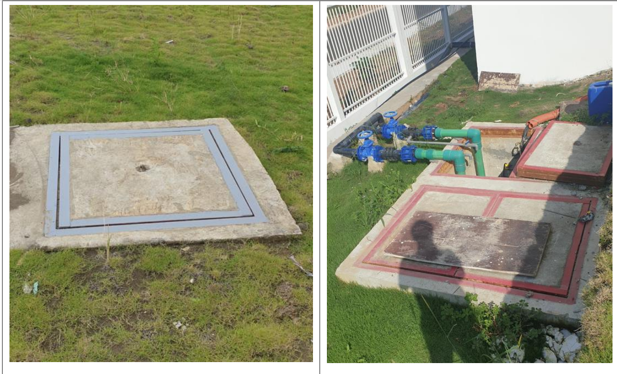
Hình 3.7 - Hồ ga thu gom và thoát nước thải của cơ sở
