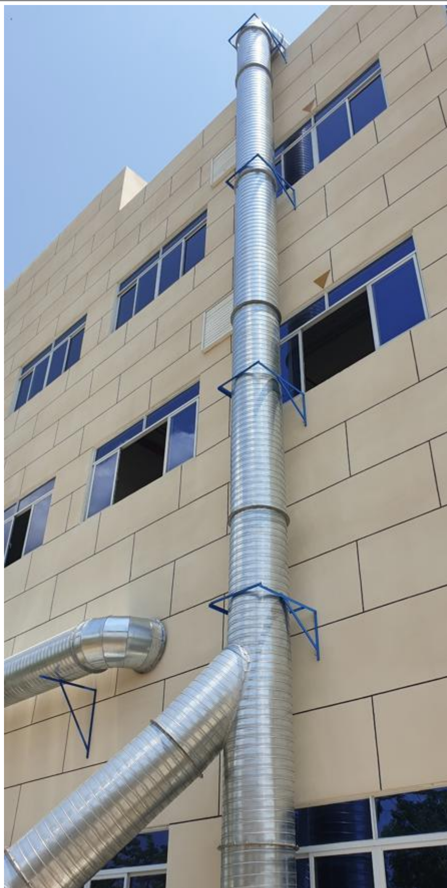
Hình 3.28 - Một số hình ảnh hệ thống xử lý khí thải khu sơn
