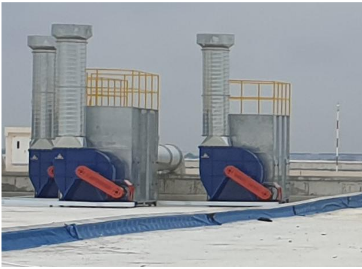
Hình 3.23 - Một số hình ảnh hệ thống thu gom và xử lý bụi sơn
