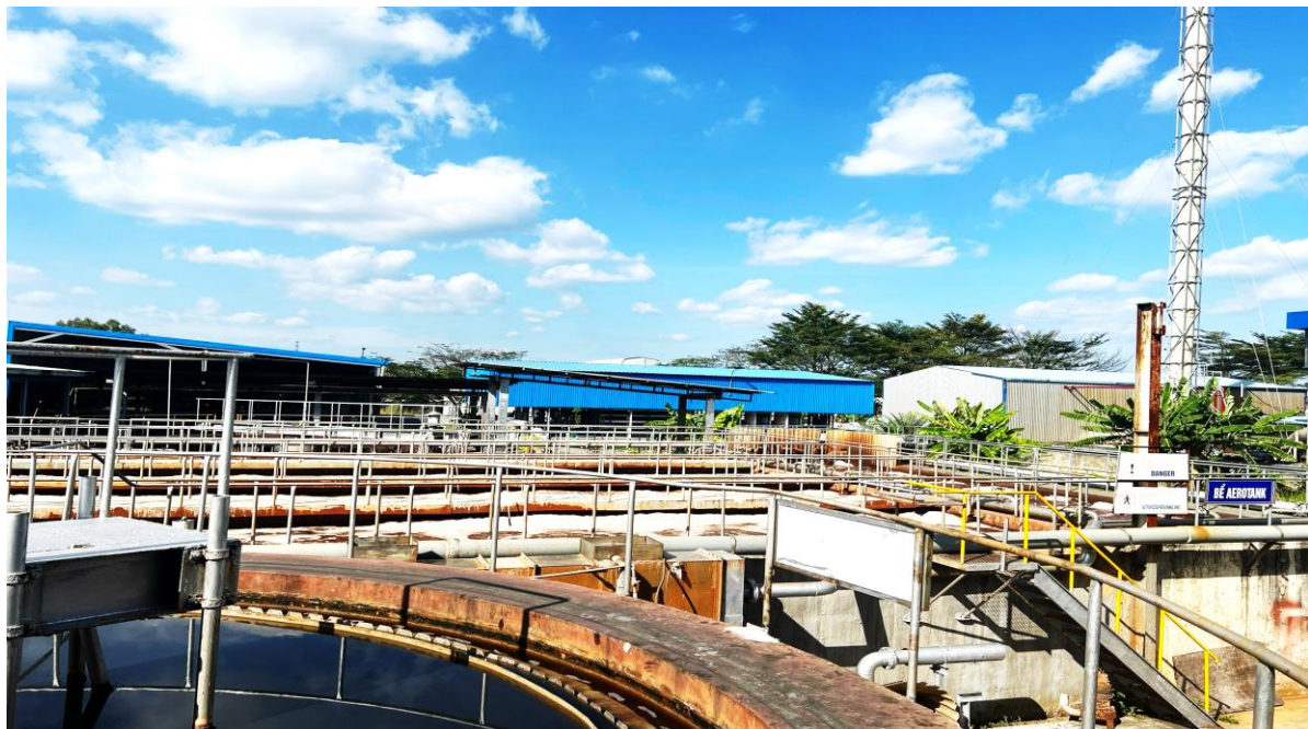
Tổng thể HTXL nước thải tại Nhà máy
