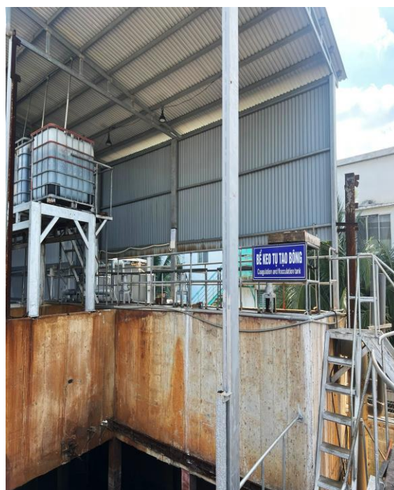
Bể keo tụ, tạo bông
