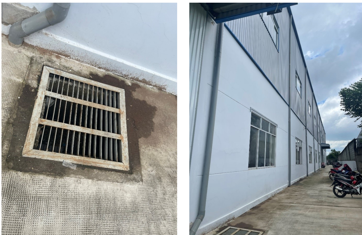
Hình 4.12 Hệ thống thu gom nước mưa
