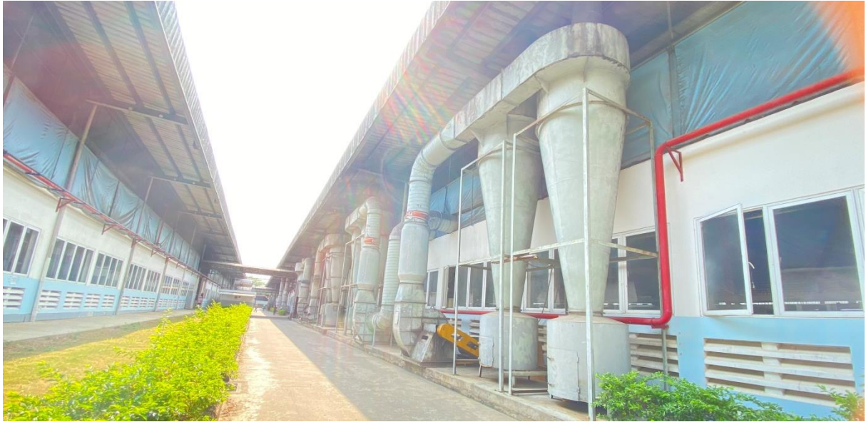
Hình 3. 14: Hệ thống xử lý bụi công đoạn mài để giày
