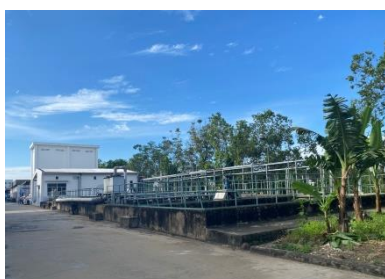
Hình 3. 6: Hệ thống xử lý nước thải 1.350 m 3 /ngày.đêm (tại lô G)
