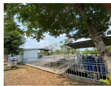
Hình 3. 8: Hệ thống xử lý nước thải 500 m 3 /ngày.đêm (tại lô D)
