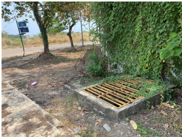
Hình 3. 4: Điểm đầu nối nước thải tại đường D5
