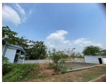
Hình 3. 7: Hệ thống xử lý nước thải 750 m 3 /ngày.đêm (tại lô D)
