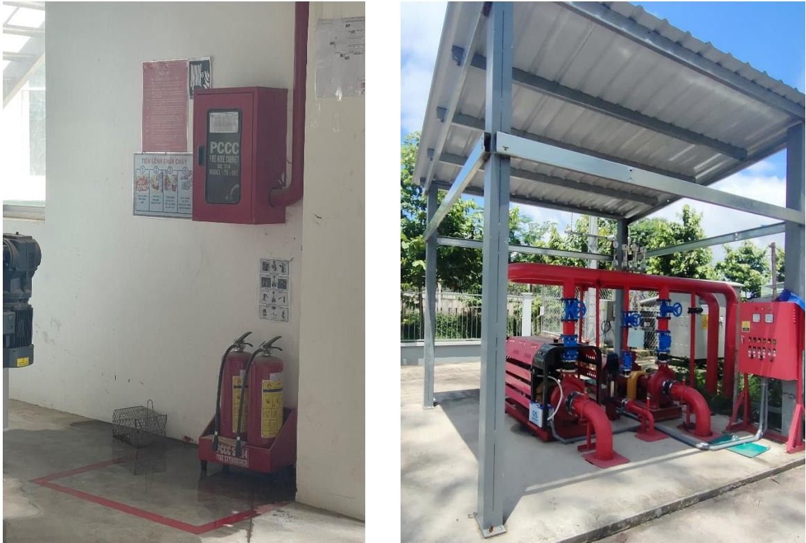
Hình 3.37 - Hệ thống phòng cháy chữa cháy
