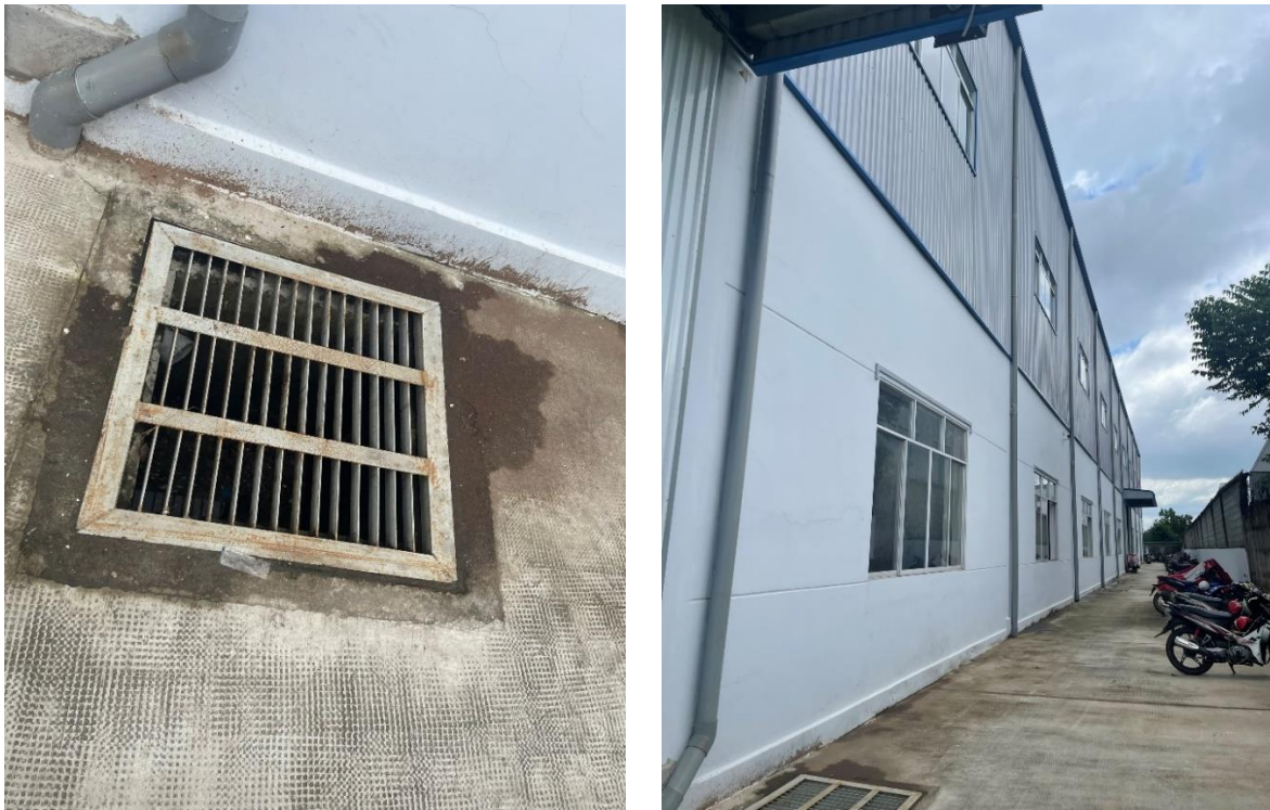
Hình 3.2 - Hệ thống thu gom nước mưa hiện hữu
