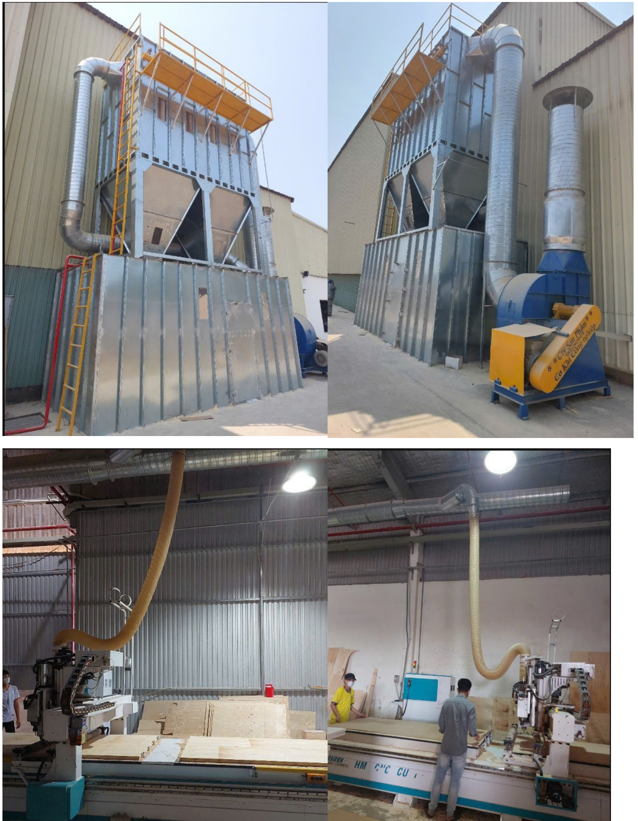
Hình 3. 6. Hình ảnh hệ thống xử lý bụi gỗ
