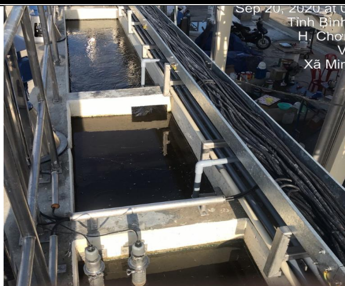
Hình 3-6: Cụm bể keo tụ - tạo bông giai đoạn 2
