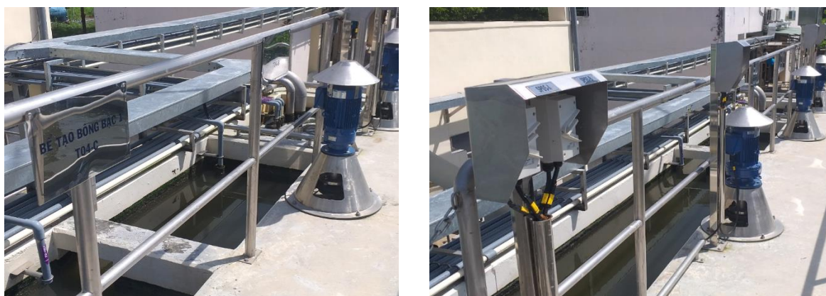
Hình 3-3: Bể keo tụ tạo bông bậc 1 – Giai đoạn 2
