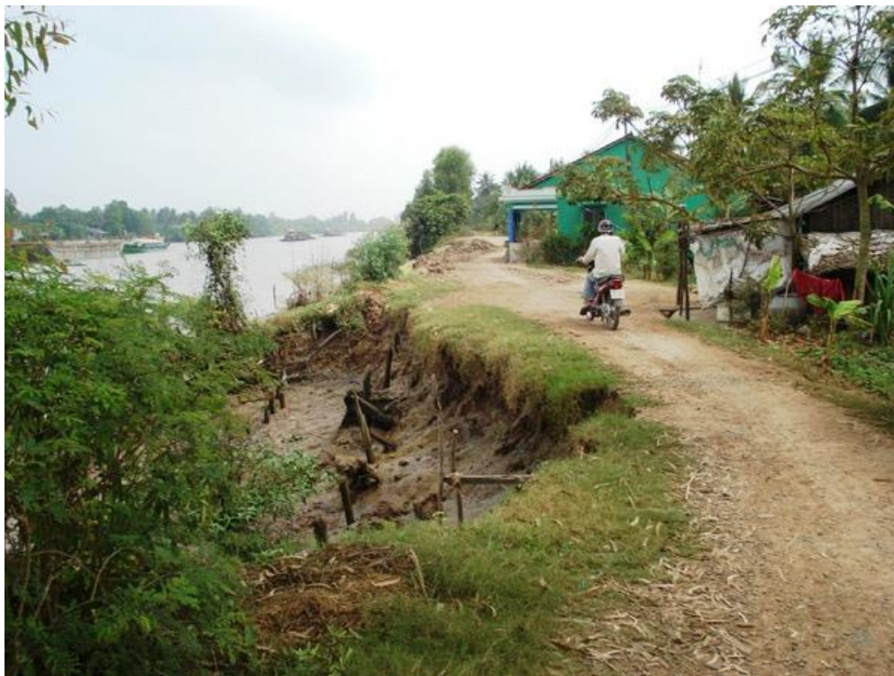
Hình vẽ 0. 4. Một đoạn Chợ Gạo bị xói lở nghiêm trọng
