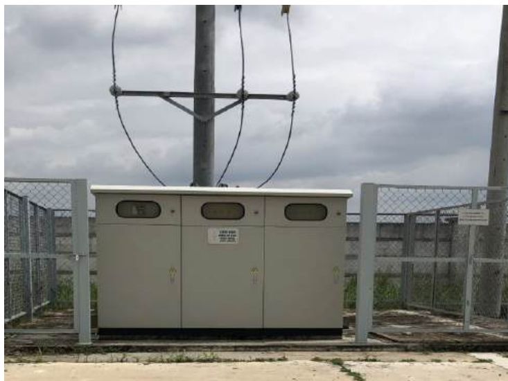
Hình 20. Trạm điện tại cơ sở
