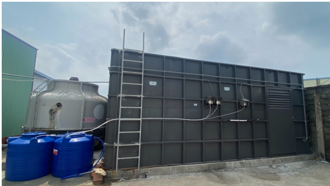
Hình 1.9. Hệ thống xử lý nước thải sinh hoạt tại nhà máy
