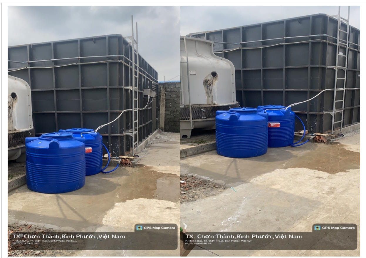
Hình 3.7. Hệ thống xử lý nước thải
