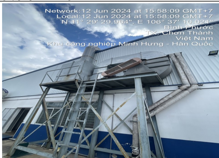
Hình 3.11. Hình hệ thống xử lý khí thải tại công đoạn sấy
