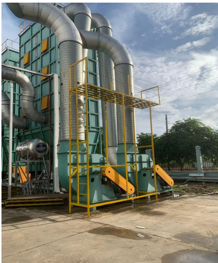
Hình 3.7. Hệ thống xử lý bụi gỗ công suất 54.000 m 3 /giờ
