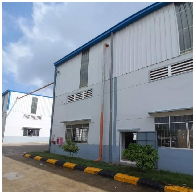
Hình 3. 1 Hệ thống ống dẫn nước mưa
