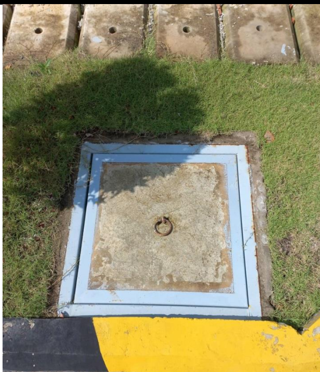
Hình 3. 4 Hố ga thu gom nước thải
