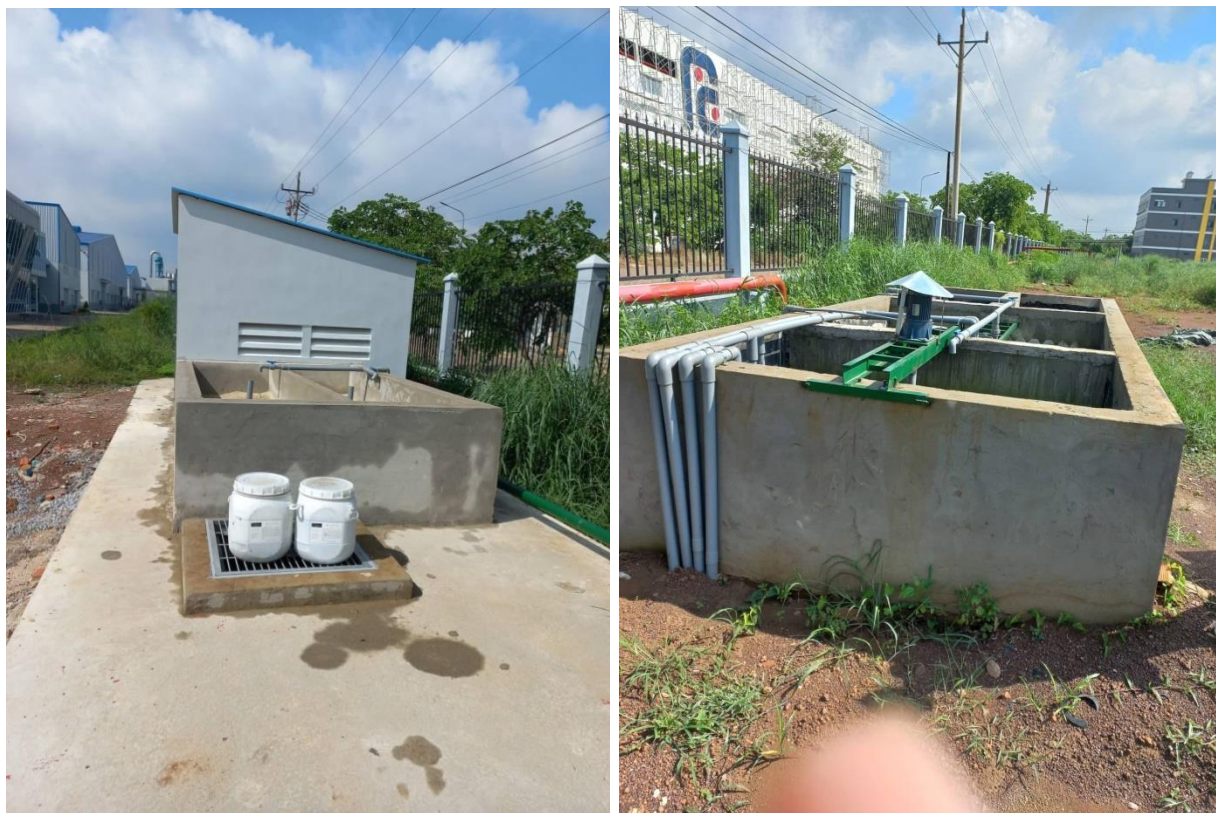
Hình 3. 7 Hệ thống xử lý nước thải công suất 125 m 3 /ngày
