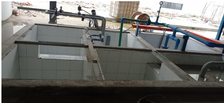
Hình 3.12. Hồ lắng bùn hệ thống xử lý khí thải lò hơi
