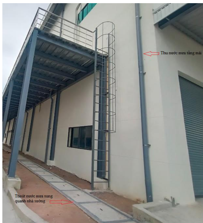
Hình 3.1. Hệ thống thu gom, thoát nước mưa
