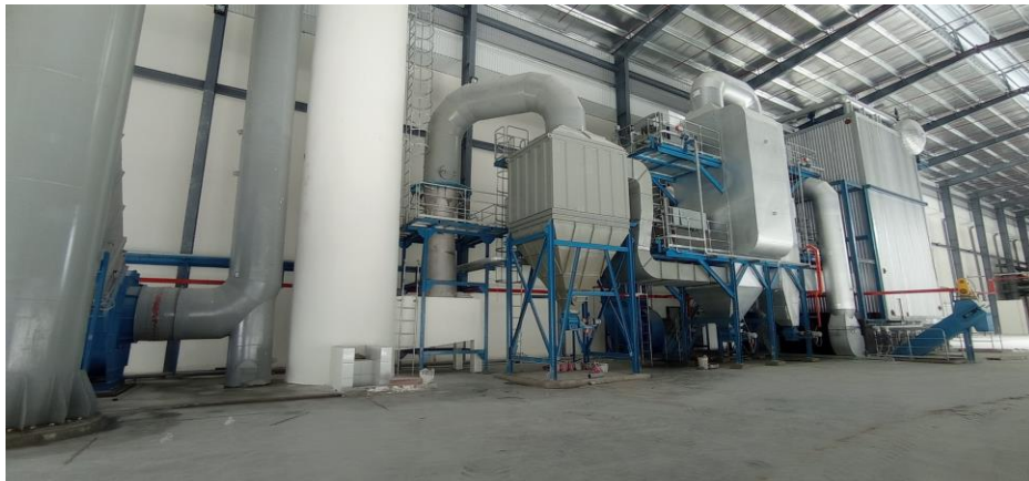
Hình 3.11. Hệ thống xử lý khí thải lò hơi
