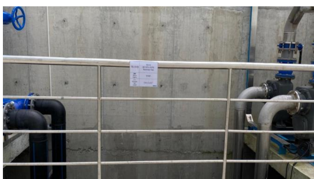
Bể chứa nước
