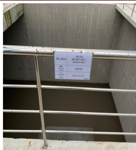
Bể điều hòa 1
