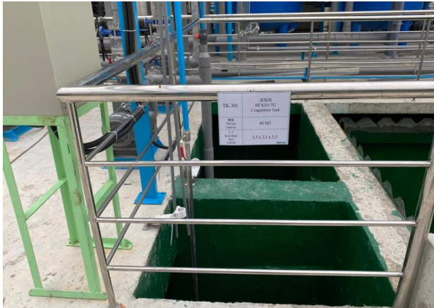
Bể keo tụ
