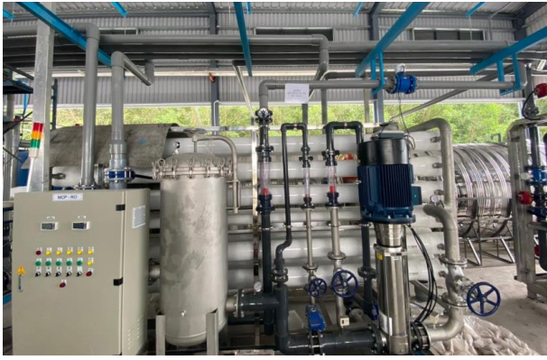
Hệ thống lọc RO
