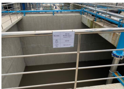
Bể điều hòa 3
