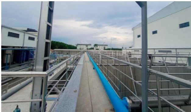
Hệ thống xử lý nước thải
