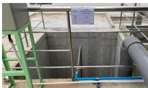
Bể điều chỉnh pH 1
