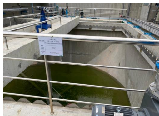
Bể lắng vi sinh
