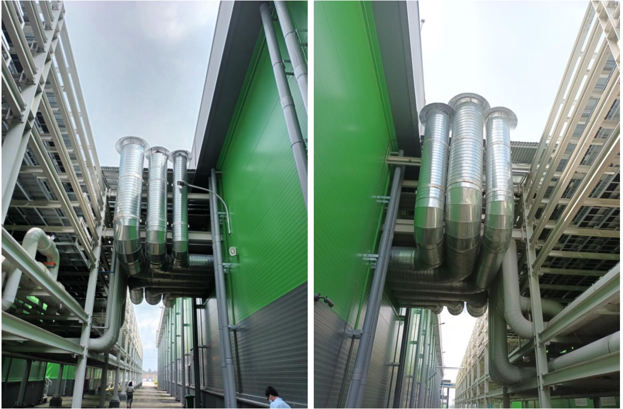
Hình 3.17. Cụm 06 ống thoát khí của hệ thống thu gom, xử lý bụi từ dây chuyền sản xuất tã dán, tã quần và khăn ướt
