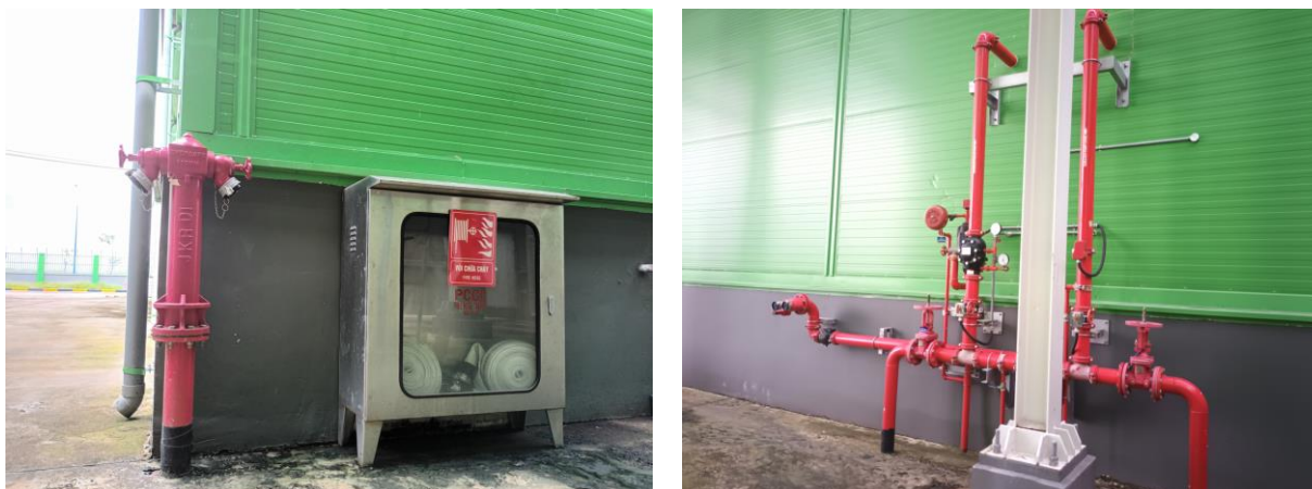
Hình 3.21. Trang thiết bị PCCC hiện hữu tại Nhà máy
