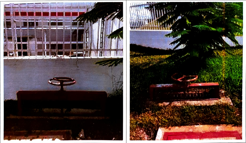
Hình 3.3 - Hồ ga thu gom nước mưa từ các nhà xưởng trước khi xả ra cống thoát nước mưa chung của Khu công nghiệp Đồng Xoài III
