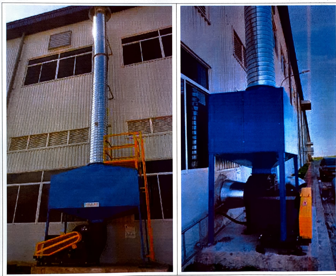
Hình 3.17 - Một số hình ảnh hệ thống xử lý hơi keo của nhà máy
