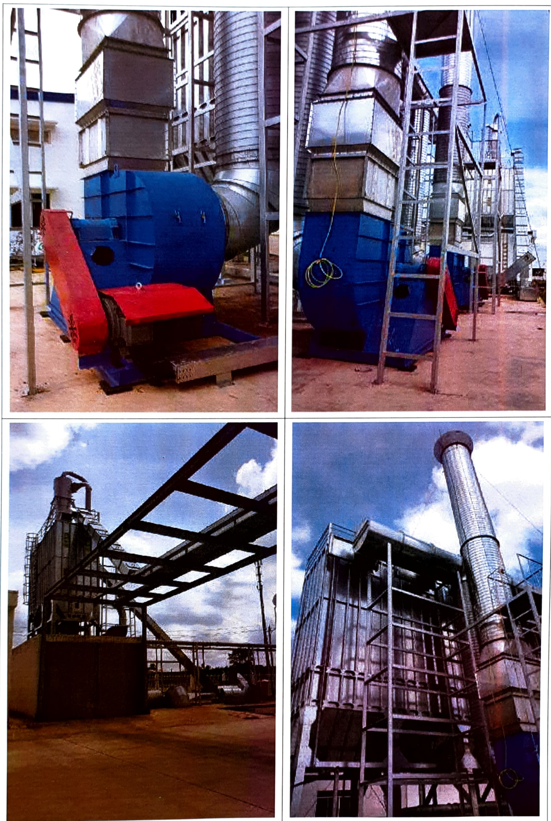
Hình 3.14 - Một số hình ảnh hệ thống xử lý bụi của nhà máy
