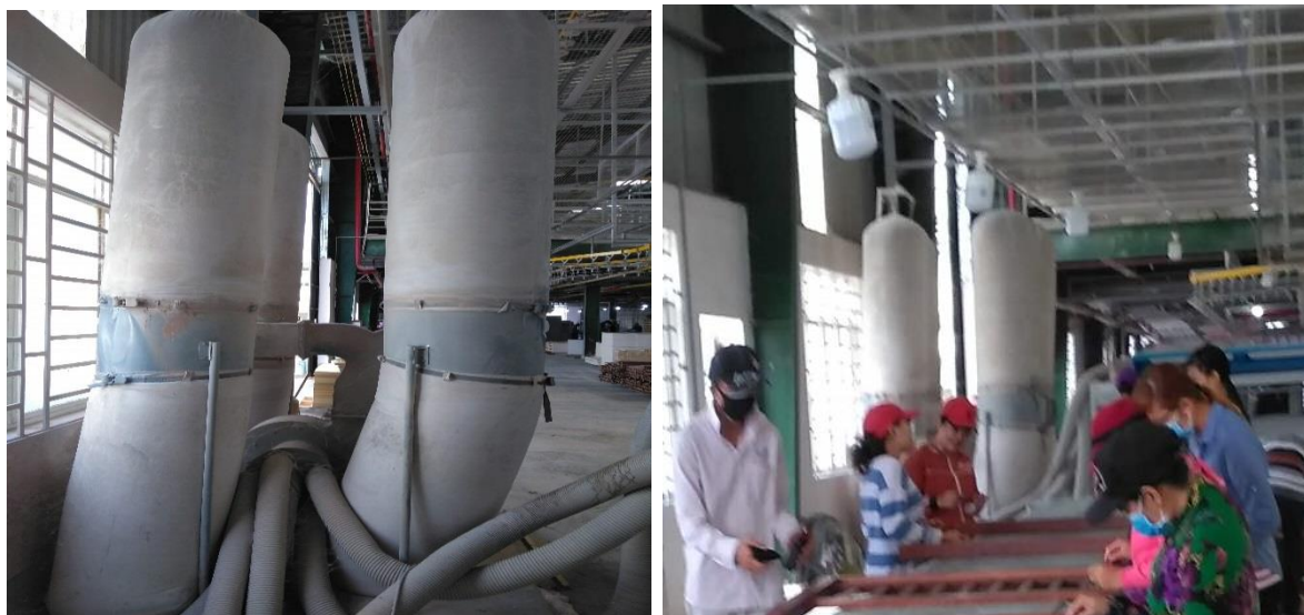
Hình 3.8 - Hệ thống túi vải di động lắp đặt thực tế tại Nhà máy.
